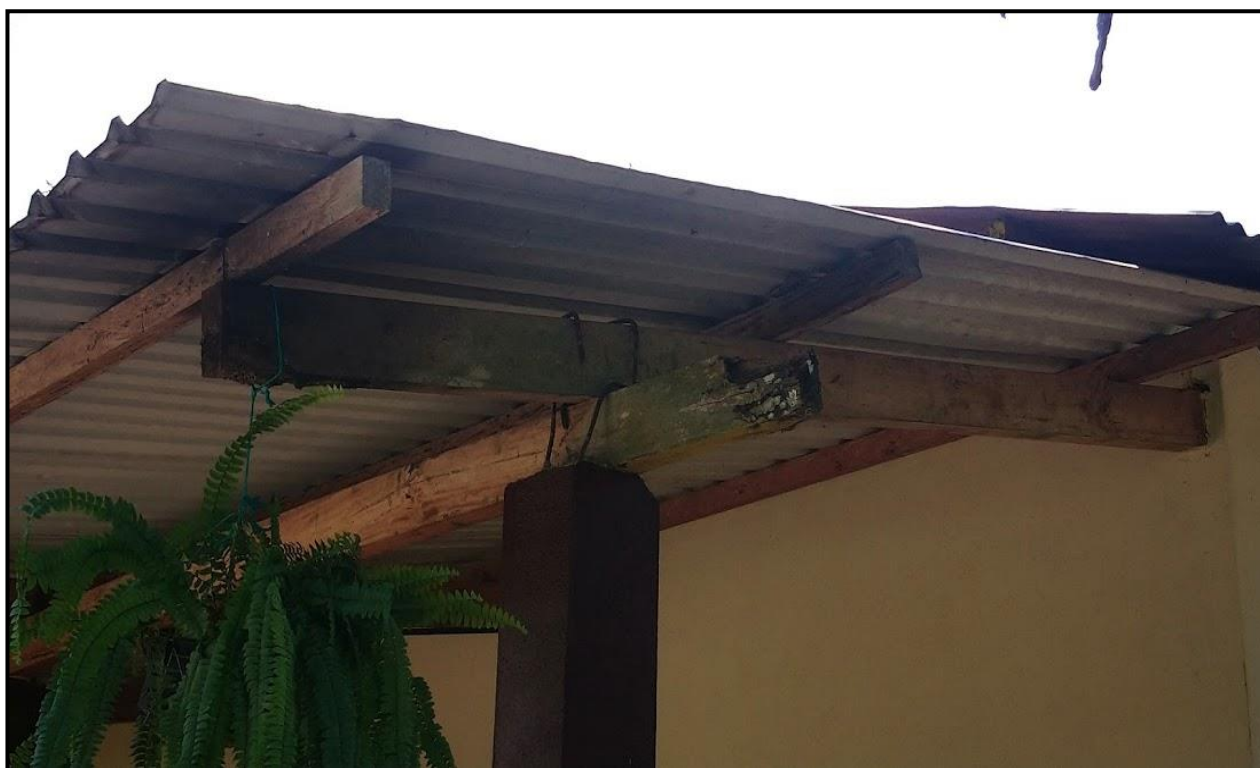
Imagen 9 Daños en estructuras PID, Aldea Ixtacapa I, San Antonio Suchitepéquez Junio 2018 a mayo 2019
