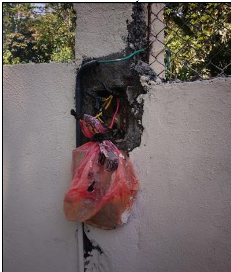
Imagen 14 Inadecuada instalación eléctrica PID, Aldea Ixtacapa I, San Antonio Suchitepéquez Junio 2018 a mayo 2019
